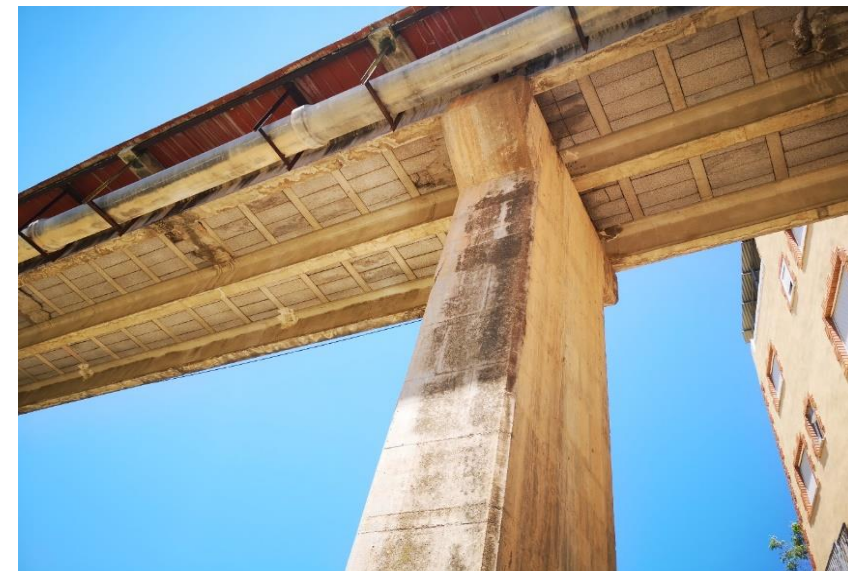
Proyecto de rehabilitación Pasarela Peatonal, Reposición hormigón y armados en el lecho del Río Cãñoles (Moixent) [Valencia].
