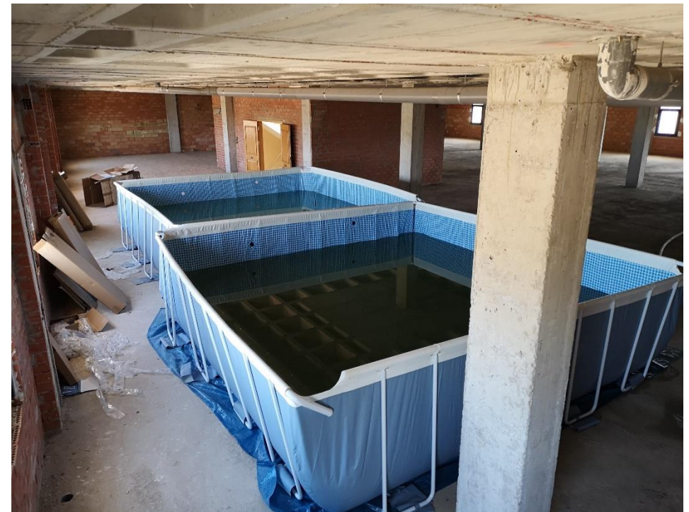
Prueba de carga para instalación de equipos en planta 3º del edificio de EGUSA ubicado en la calle dels Calderers, nº86-88 (Alboraya) [Valencia].
