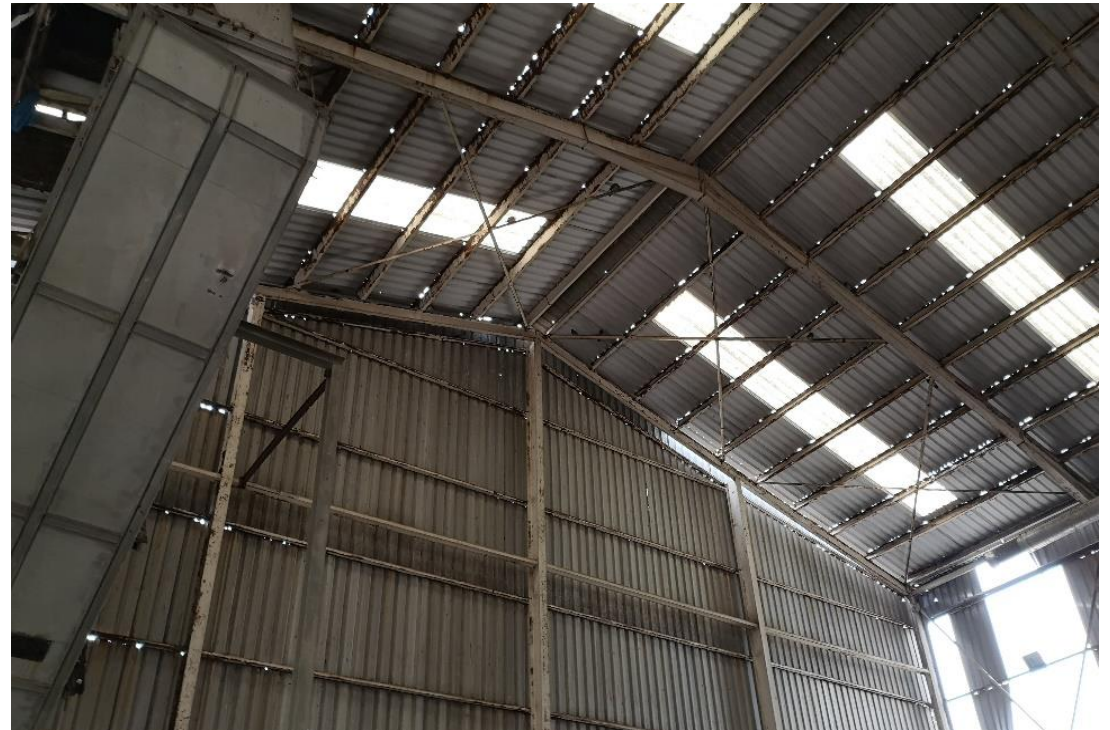
Peritación de la estructura, cerramiento y cubrición de edificio de metanización de la planta de Residuos Sólidos Urbanos en Burgos (Castilla y León).
